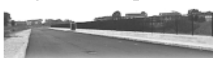
Intorno all'enorme quadrilatero che ospiterà la cittadella scolastica sono state realizzate delle ampie strade asfaltate (sopra), con marciapiedi e parcheggi. Una recinzione delimita tutto il perimetro e isola il cantiere.
