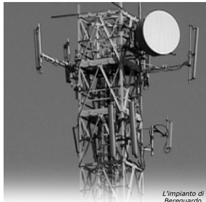
L'impianto di Bereguardo.
